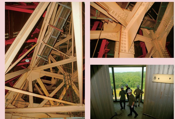
⑫建築の専門家グループ「北海道百年記念塔の未来を考える会」の令和4年7月3日内部調査写真。5年以上放置状態であったとは思えないほど塔体は健全で、少しの不安も感じられなかった
