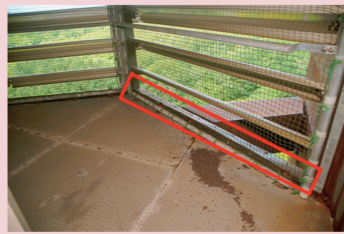
⑨令和4年7月3日「北海道百年記念塔の未来を考える会」内部調査写真。落下したのは赤枠の部材。定期点検で容易にぐらつきを発見できる場所にある
